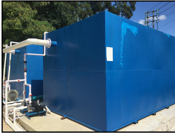
项目废水处理装置
