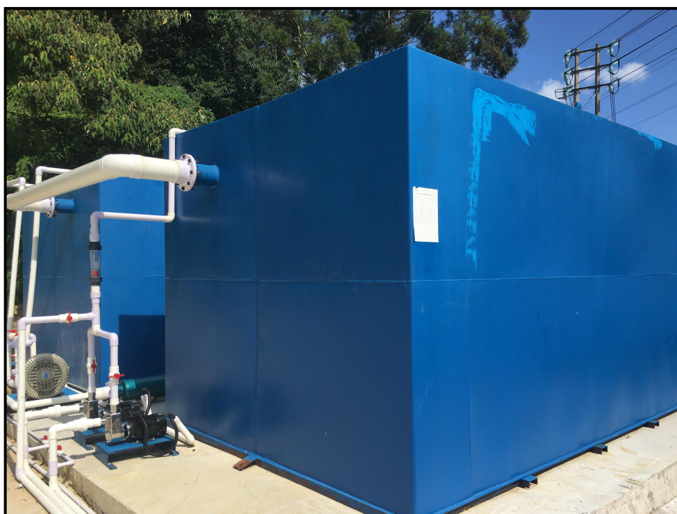
图 4-1 已建废水处理设施
