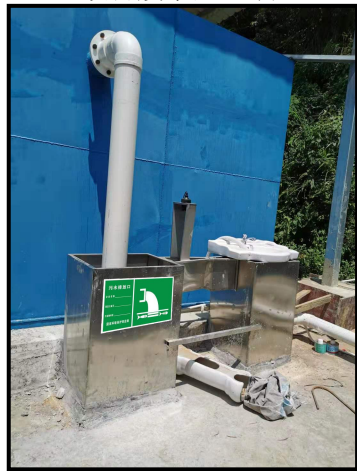
项目废水处理装置
