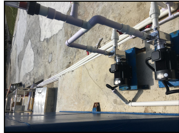
项目废水处理装置
