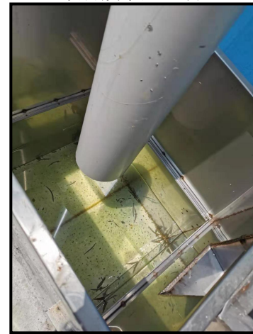
项目废水处理装置
