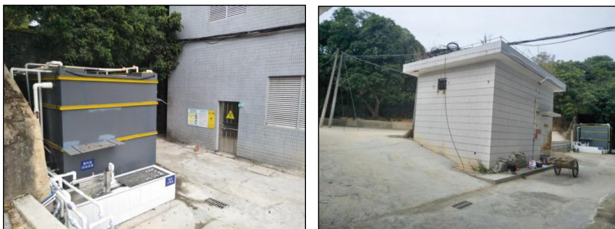
图 4-1 已建废水处理设施
