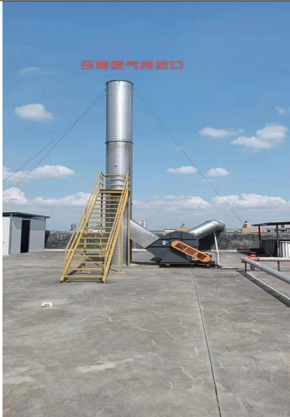
“气水混合洗涤器+湿式静电净化器+活性炭吸附装置”处理设施”（压铸工艺废气处理设备）
