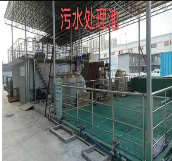
自建污水处理站
