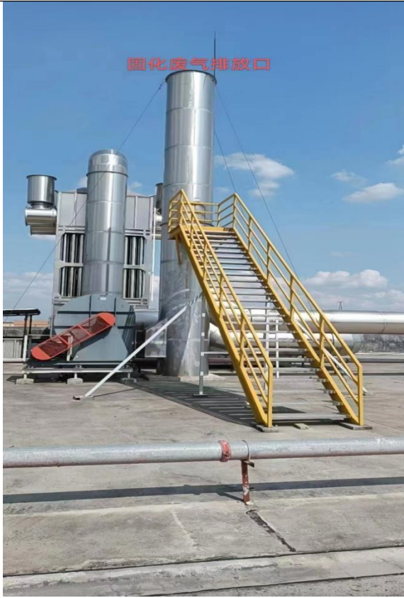
“水喷淋”装置处理（五金工艺固化废气处理设备）
