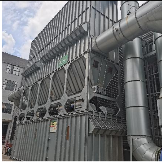
干式脉冲除尘器（实木工艺木加工、木磨含尘 废气处理设备）
